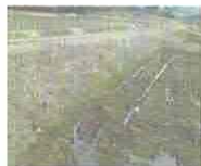
I. 草刈が必要な法面 I. この法面で「危険の群像」を後のページでします
